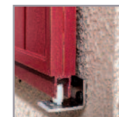
Guidage ponctuel bas fixé en façade
